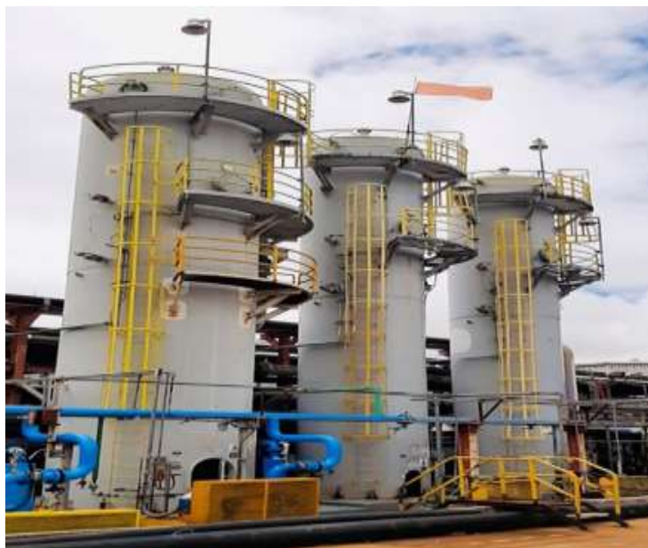
Figura 24. Torres de desoxigenación proceso Merrill Crowe (Newmont Yanacocha, 2023)
