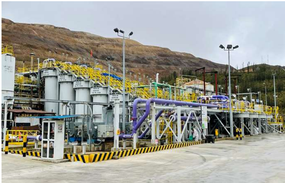
Figura 19. Planta de adsorción y desorción, planta Pampa Larga. (Newmont Yanacocha, 2023)
