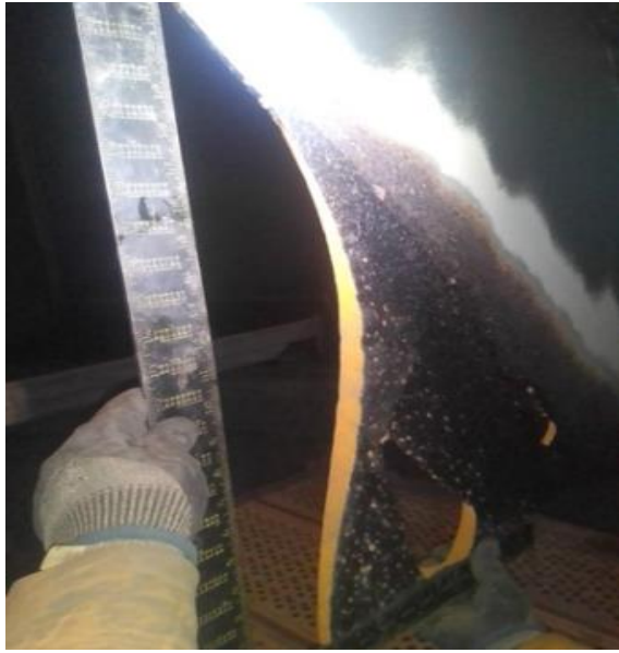
Figura 22. Toma de medidas de deflector dañado
