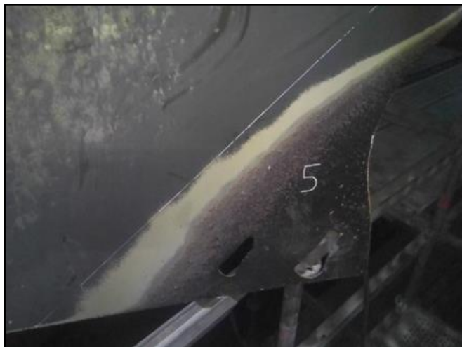
Figura 19. Estado de deflector N.º 2
