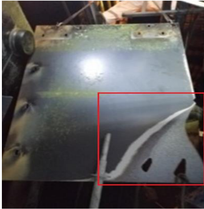
Figura 20. Estado de deflector N° 03
