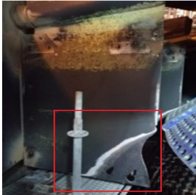
Figura 1. Estado de los deflectores en celdas de flotación
