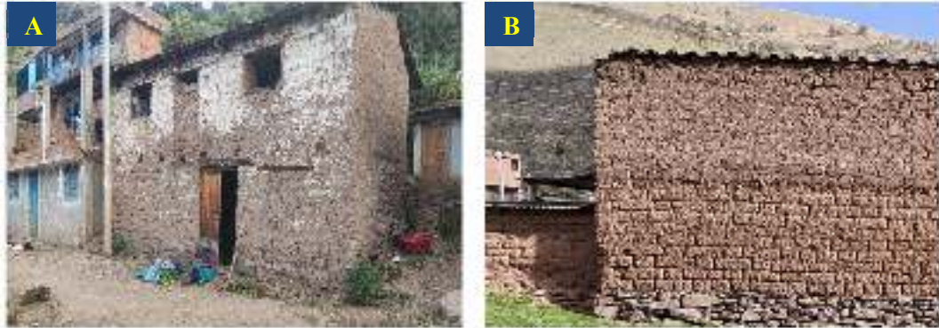
Figura 1. Viviendas de adobe. A) Vivienda de dos niveles con rajaduras e inclinación; B). Vivienda de dos niveles con problemas de mala cimentación y adobes en mal estado de conservación. Imágenes tomadas en la zona de estudio, Comunidad Unuraqui, distrito Calca, provincia y departamento Cusco
