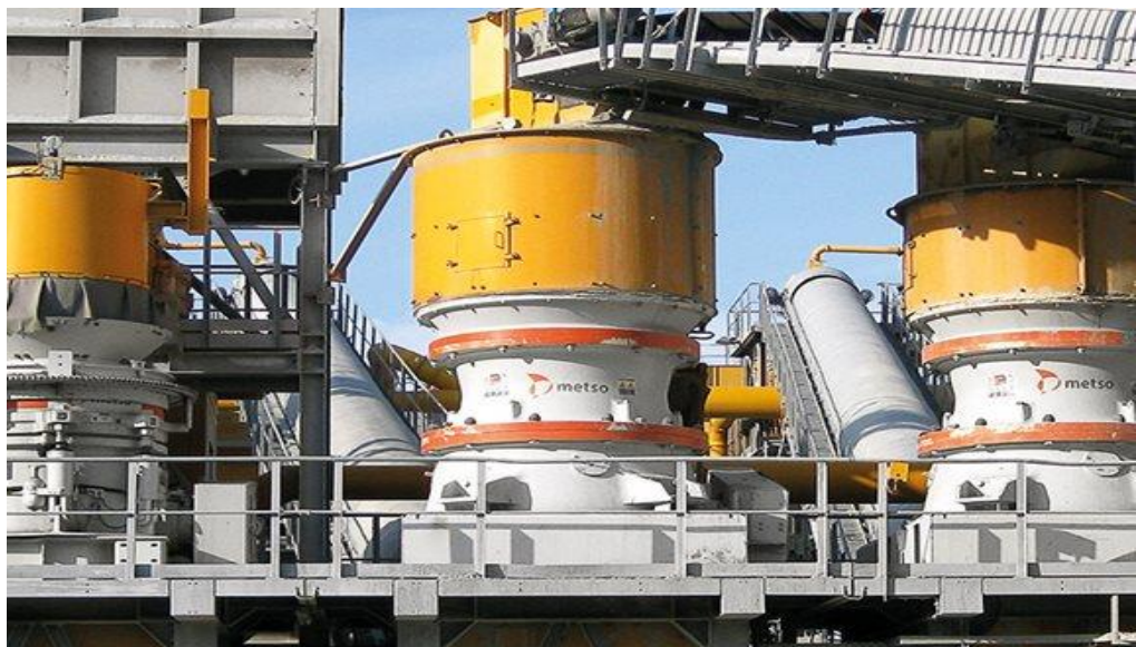
Figura 2. Equipo del proceso de chancado
