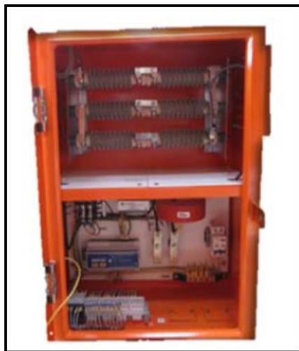
Figura 8. Tablero NGR – componentes Fuente. Oem Electric
