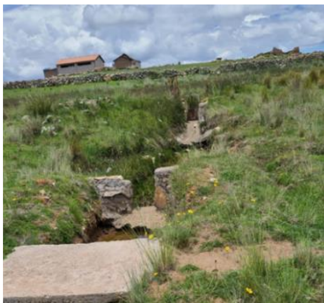
Figura 3. Estado actual del canal del centro poblado de Pacastiti.
