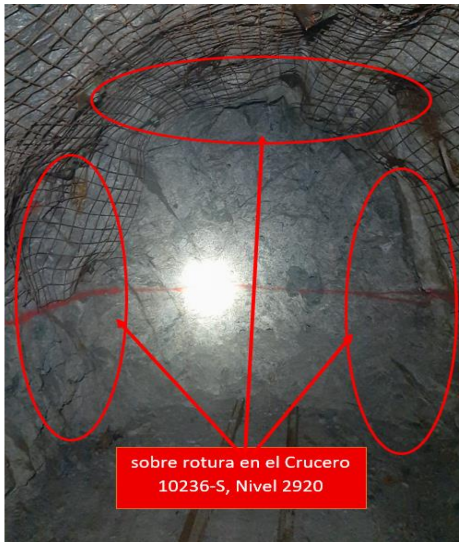
Figura 11. Situación actual de la sobre rotura en el Crucero 10236 - S, Nivel 2920 Tomada del Departamento de Perforación y Voladura (12)
