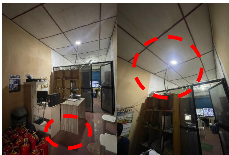
Figura 10. Deficiencias en el área administrativa.
