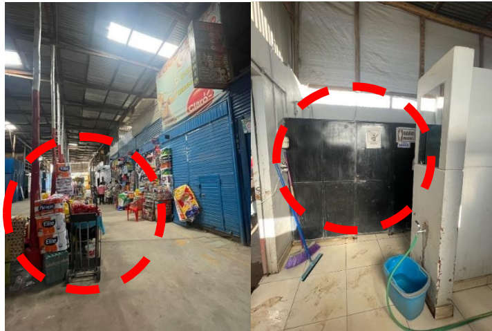
Figura 8. Desorden en el área de comercial de la zona seca y deficiencias en los servicios higiénicos.
