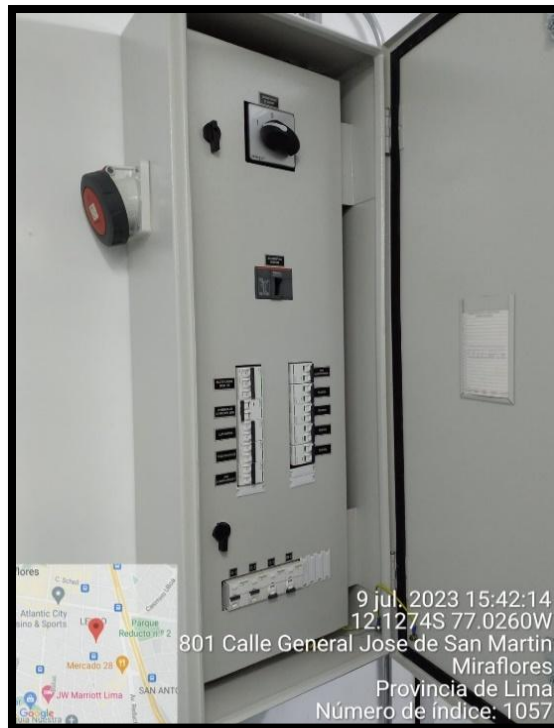
Figura 27. Tablero general instalado
