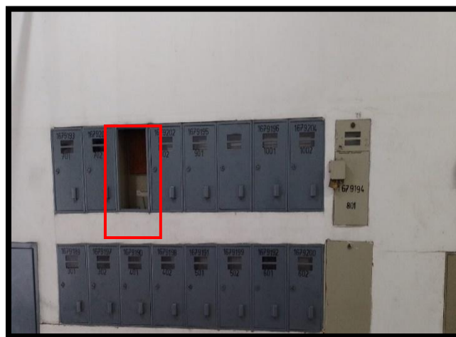
Figura 30. Ubicación de la caja portamedidor en el banco de medidores
