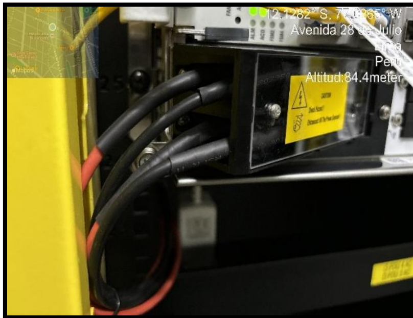
Figura 73. Cables de energía de la fuente A y B del equipo OLT Nokia 7360
