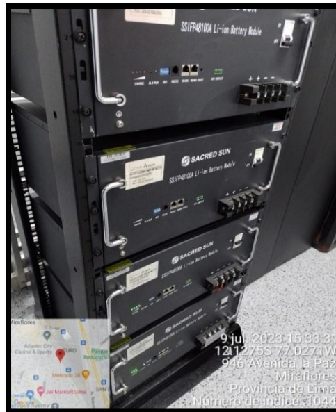
Figura 43. Rackeado de baterías
