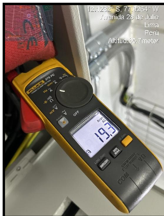
Figura 85. Medición de corriente en la fase R en el tablero general del nodo
