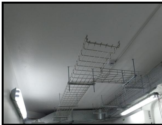
Figura 37. Bandeja porta cables instalado
