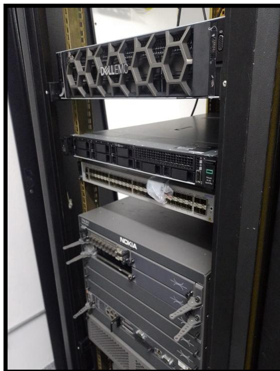
Figura 76. Servidores y equipo Switch rackeados
