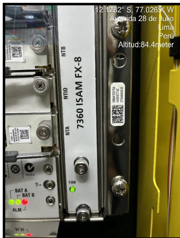
Figura 74. Pruebas de encendido del equipo OLT Nokia 7360 ISAM FX-8
