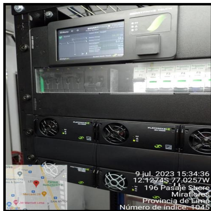
Figura 47. Energización e instalación de módulos rectificadores y rectiverter
