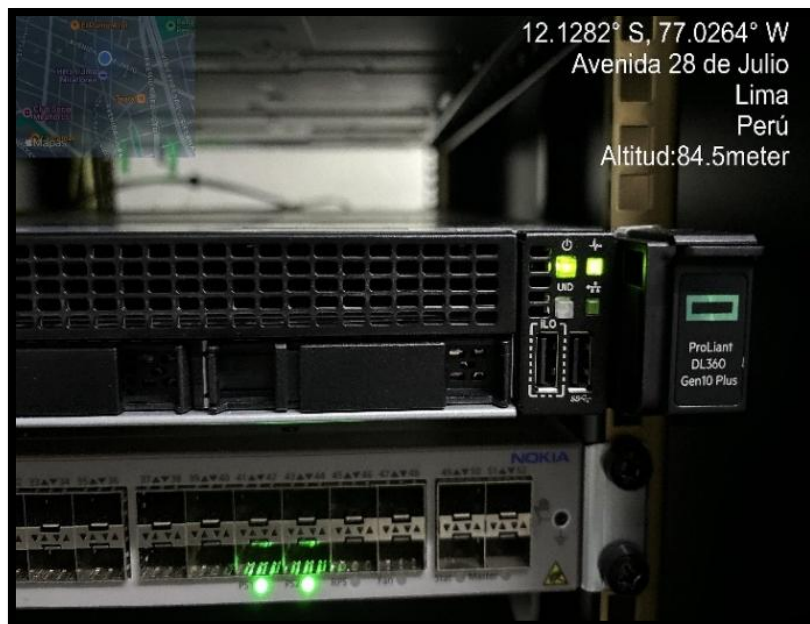
Figura 79. Pruebas de encendido de servidores
