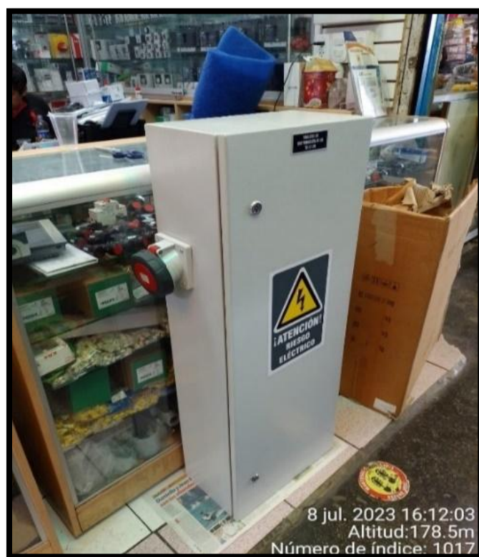
Figura 26. Tablero general mandado a fabricar
