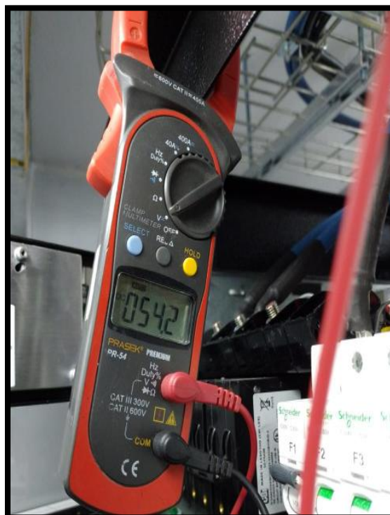
Figura 46. Verificación de tensión de llegada en DC al Power Core
