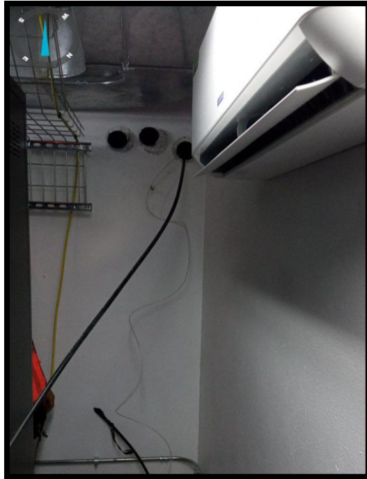
Figura 57. Entrada del cable de fibra óptica al nodo Miraflores
