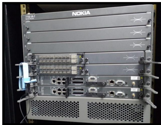
Figura 67. Equipo Router DWDM Nokia 7750 SR-7 rackeado
