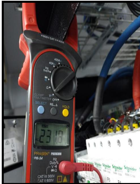
Figura 45. Verificación de tensión de llegada en AC al Power Core
