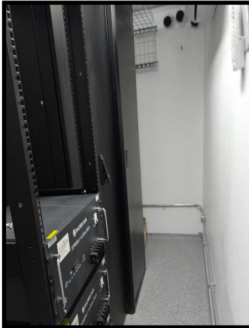
Figura 91. Vista lateral derecha con gabinetes y equipos instalados
