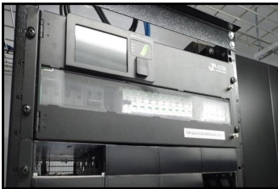
Figura 42. Rackeado e instalación del Power Core
