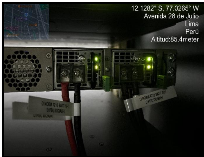
Figura 77. Cables de energía fuente A y B del equipo Switch Nokia 7210
