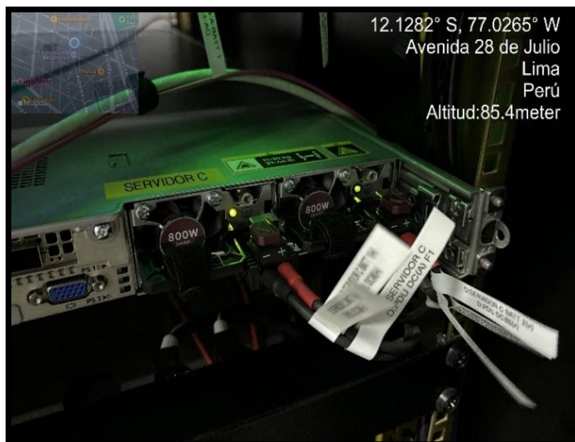
Figura 78. Cables de energía fuente A y B del equipo servidor DELL
