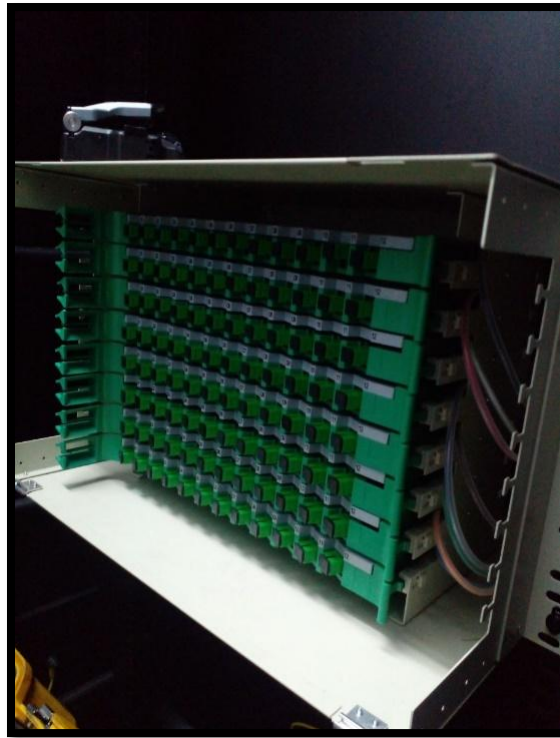
Figura 65. Rackeado de ODF en gabinete
