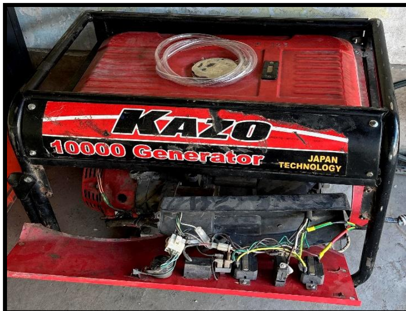
Figura 89. Instalación de grupo electrógeno Kazo de 10 kW
