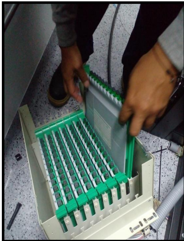
Figura 62. Instalación de ODF de 96 hilos dentro del nodo
