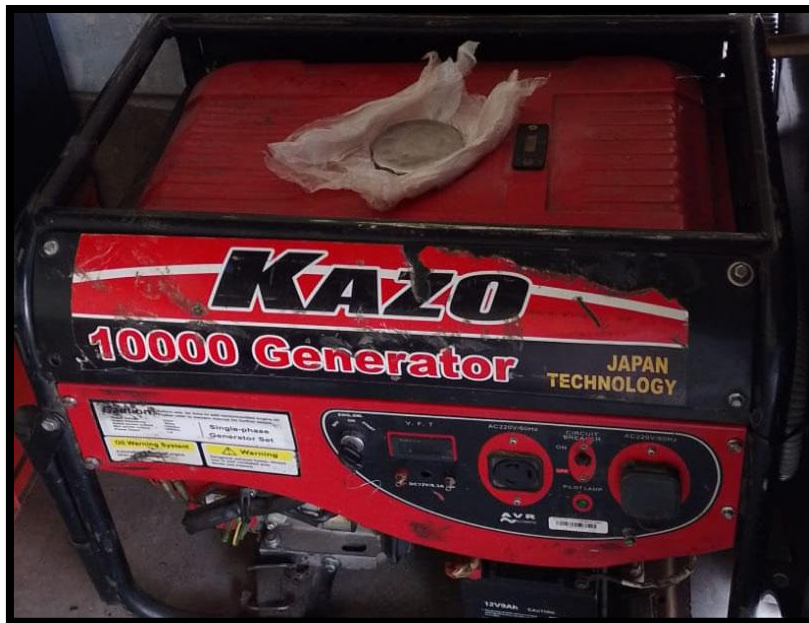
Figura 88. Grupo electrógeno Kazo de 10Kw
