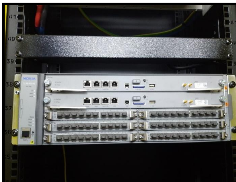
Figura 80. Rackeado de Router Nokia 7250 IXR-R6
