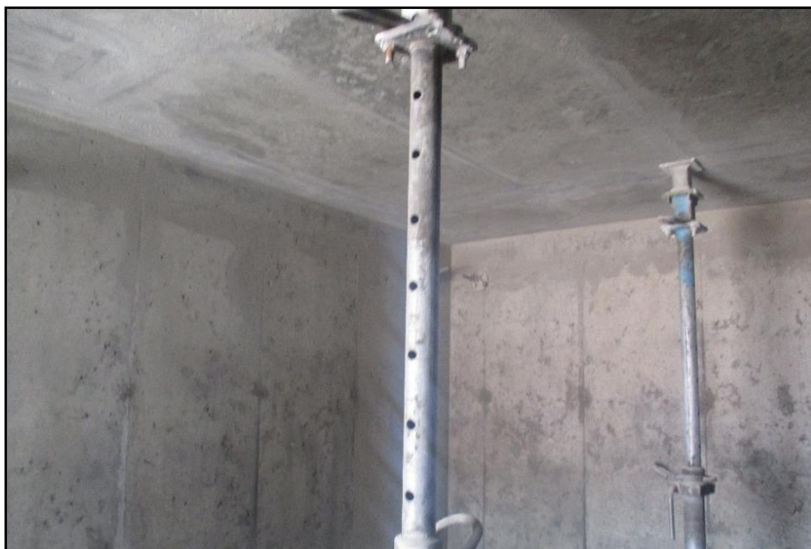
Figura 54: Amolado de muros y losa, trabajos de “no calidad”, Edf. 5 VBP
