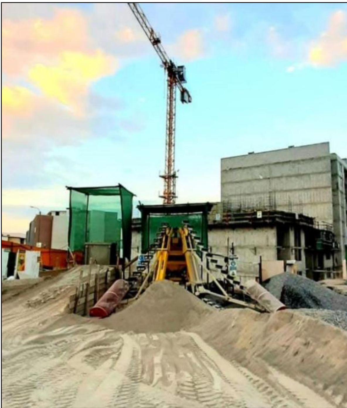
Figura 59: Planta de Concreto de la empresa cumbres SAC
