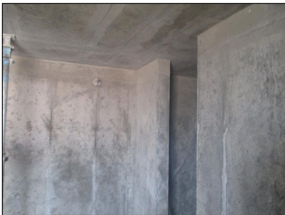
Figura 55: Corrección de vanos de puerta y esquinas, trabajo de no calidad, Edf. 6 VV2
