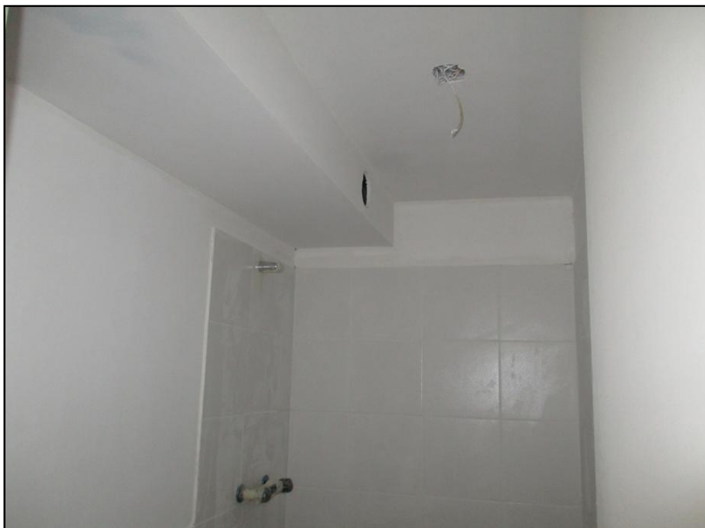
Figura 57: Enchape en baños Edf. 5 VBP
