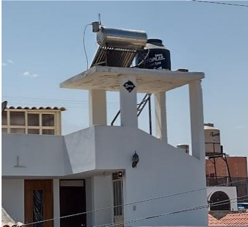
Figura 2. Terma solar instalada en techo de escalera sin barandas de protección.
