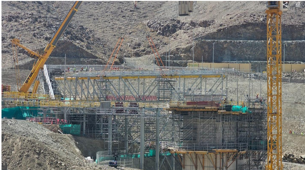
Imagen 46: Puente de Acceso que conecta la plataforma de operaciones con la Losa techo, TC.05
