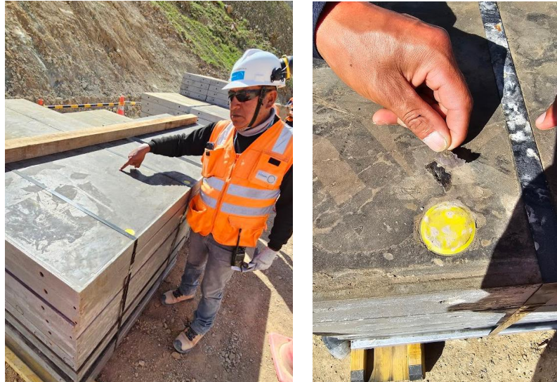
Imagen 20: Materiales y accesorios de Ulma con daños en diferentes puntos
