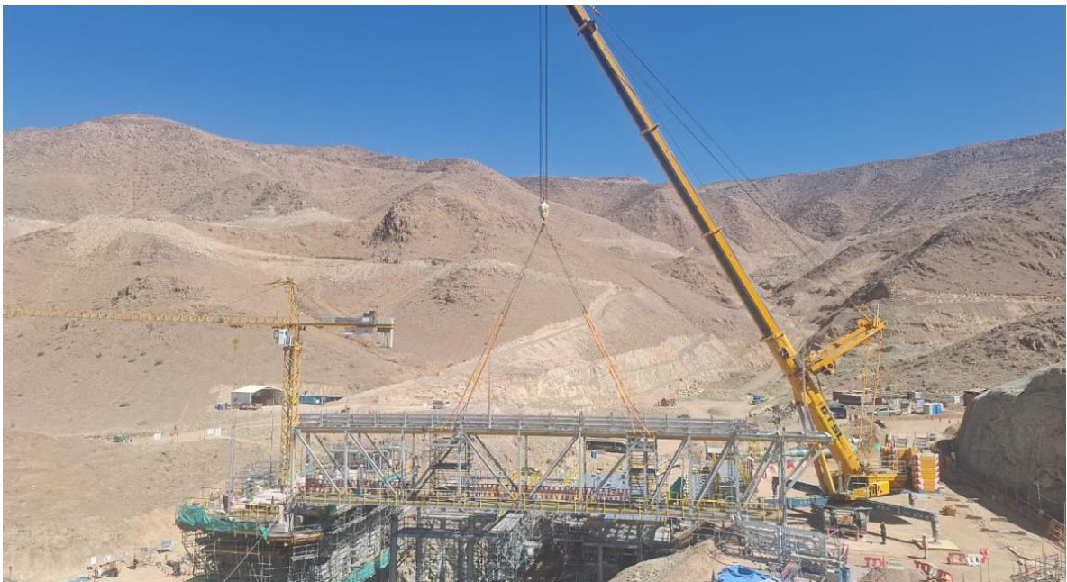
Imagen 63: Torre de Captación N°5 Finalizada con su Puente de Acceso (Obras civiles)
