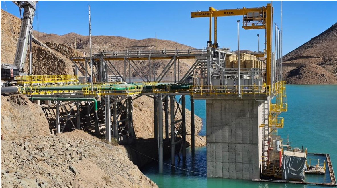
Imagen 68: Torre de Captación N°4 Imagen referencial para la Torre de Captación N°5
