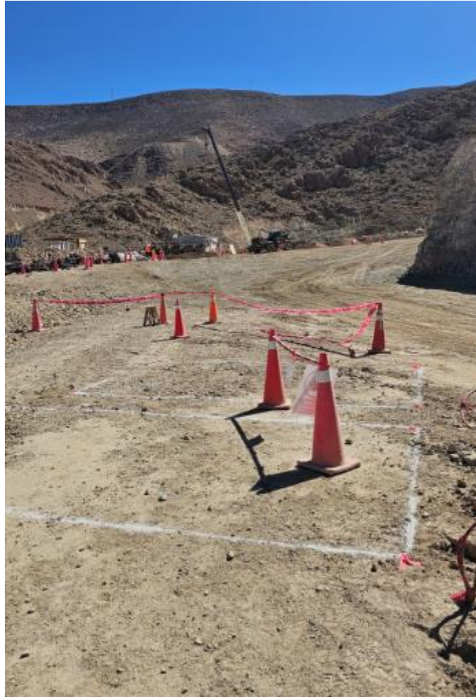
Imagen 58: Trazos de Topografía para excavación y colocación de los cajones disipadores y drenajes.
