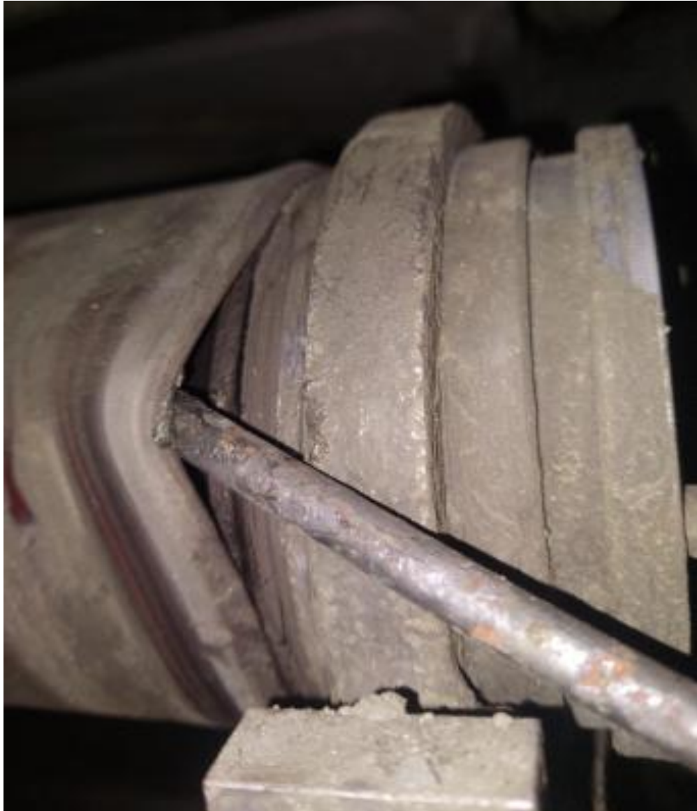
Figura 10. Desgaste de forro del rodillo detectado Fuente: Elaboración propia
