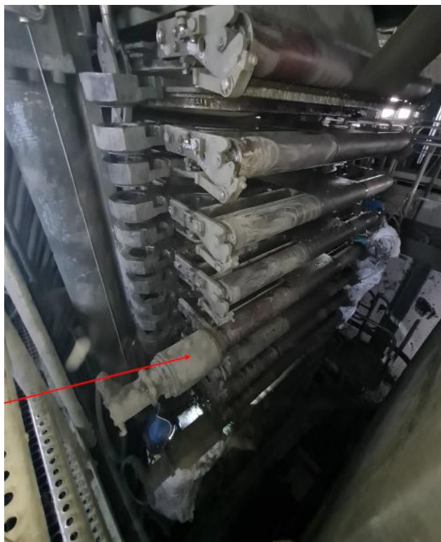
Figura 6. Rodillos y placas de filtro Larox Fuente: Elaboración propia
