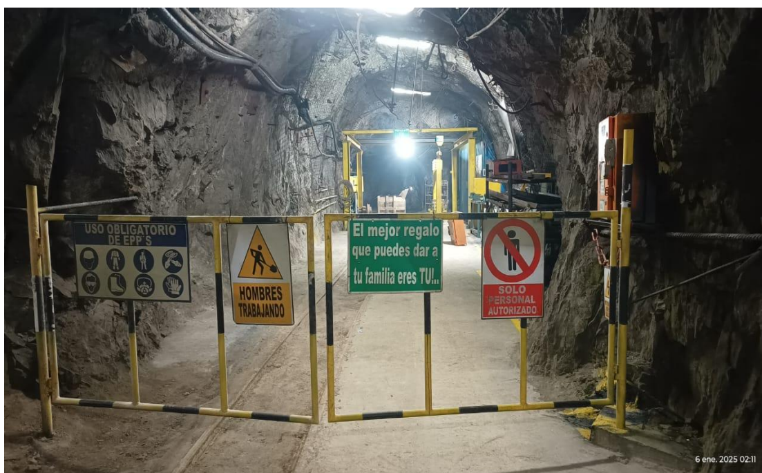
Figura 42. Taller nivel 21 vetas implementado con letreros de seguridad y tablero de seccionador eléctrico para bloqueo de energía
