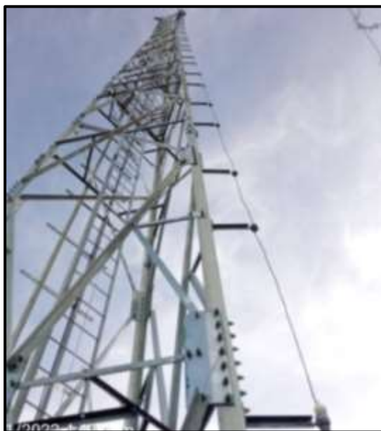
Figura 106. Aterramiento de pararrayo.
