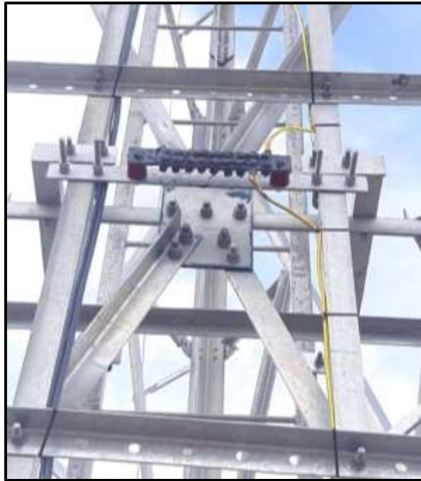
Figura 112. Aterramiento a barra RF de torre.
