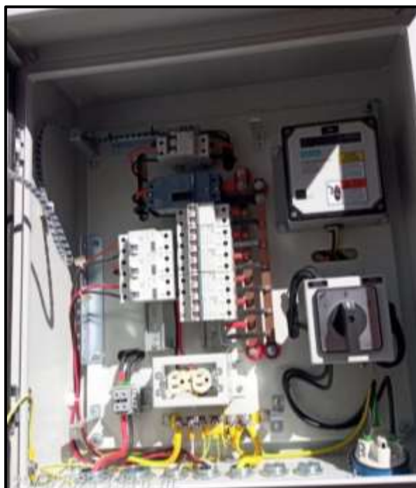
Figura 110. Aterramiento a tablero general.
