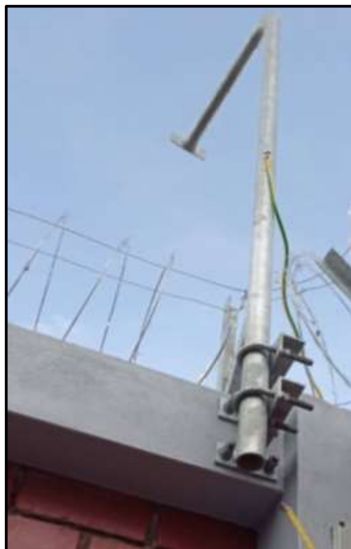
Figura 103. Aterramiento de soporte de cámara.
