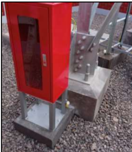
Figura 109. Aterramiento de gabinete de extintor.
