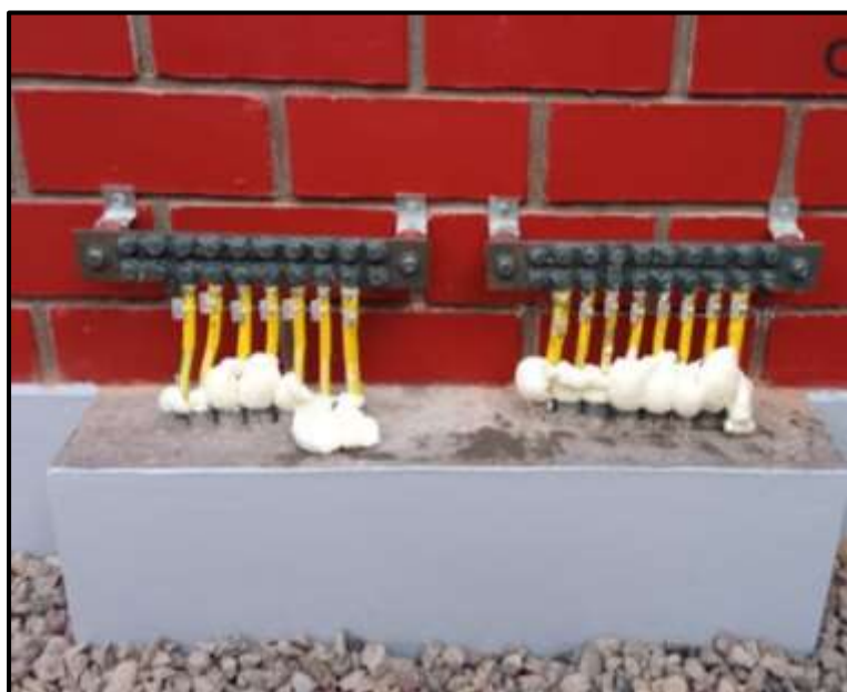
Figura 101. Barras borneras SGB 1 y SGB 2.
