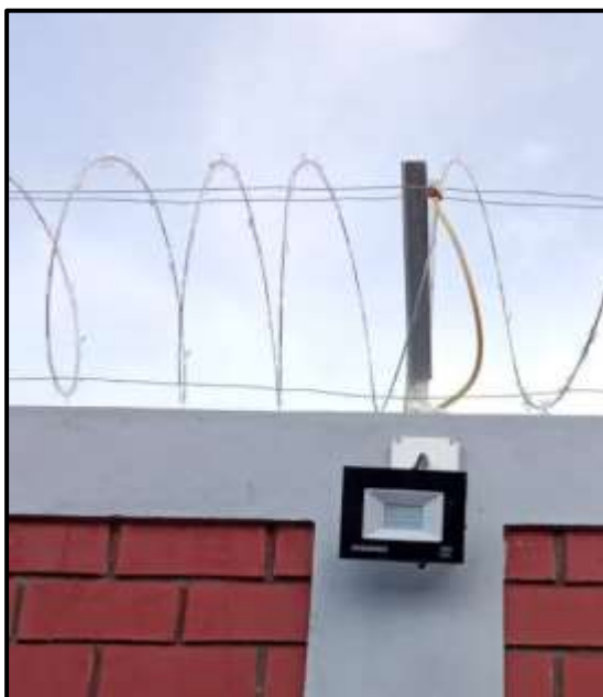
Figura 104. Aterramiento de soporte de concertina.
