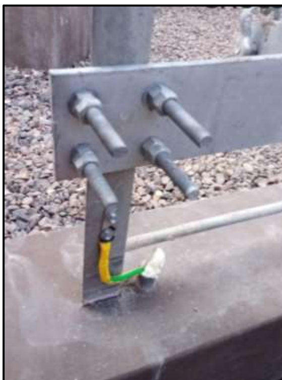
Figura 107. Aterramiento de escalerilla peatonal.
