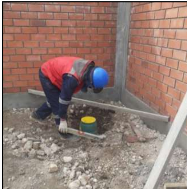
Figura 94. Control de pozos a tierra.
