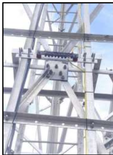
Figura 76. Barras borneras de torre. Fuente: Elaboración propia
