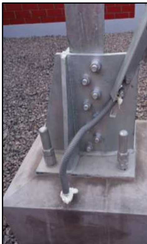
Figura 108. Aterramiento de bases de torre.
