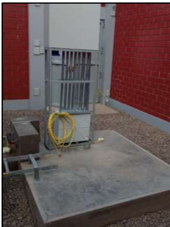
Figura 111. Aterramiento a gabinete de shelter.
