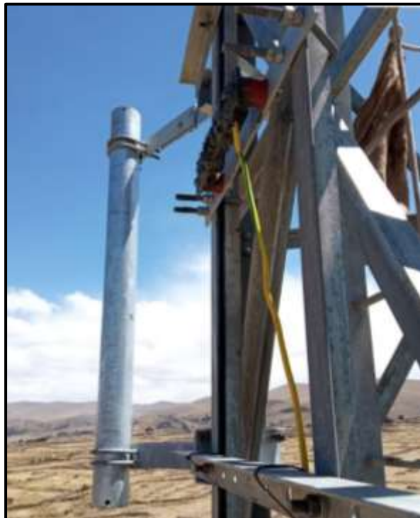
Figura 113. Interconexión de barras de torre.
