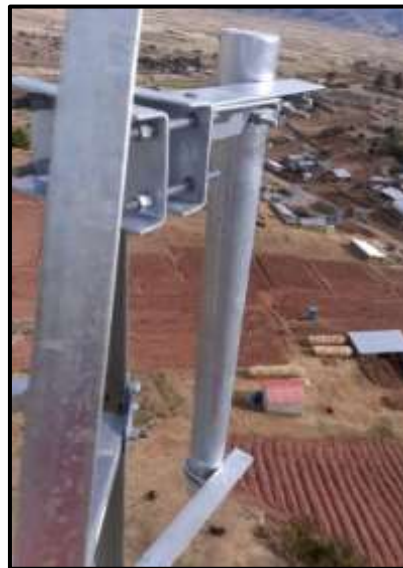
Figura 73. Soporte antena MW. Fuente: Elaboración propia
