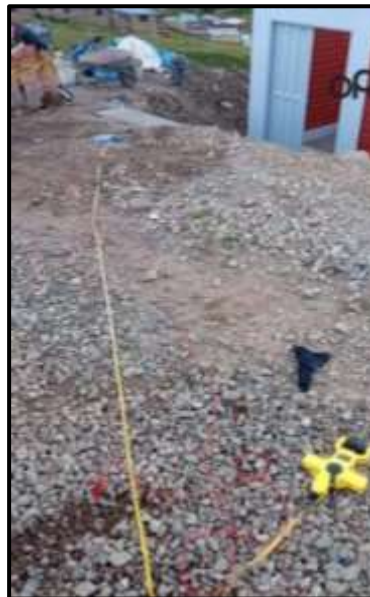
Figura 96 Medición de ohmiaje.
