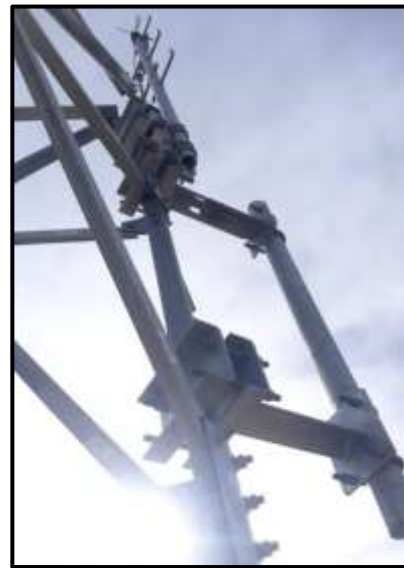
Figura 74. Soporte antena RF. Fuente: Elaboración propia
