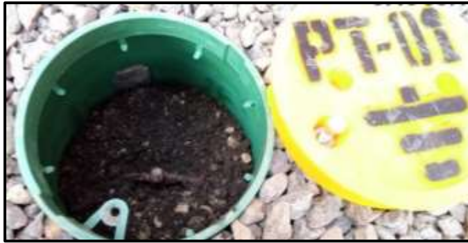
Figura 95. Control de rotulado de los pozos a tierra.
