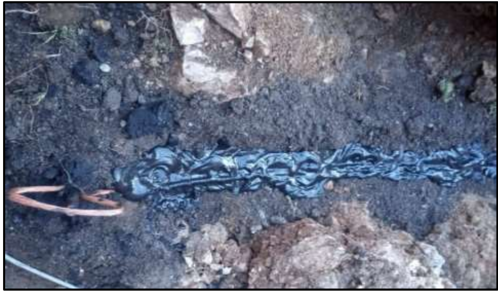
Figura 93. Control de la interconexión de pozos a tierra.
