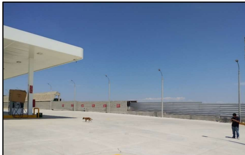
Figura 16. Verificación de sistema de iluminación exterior
