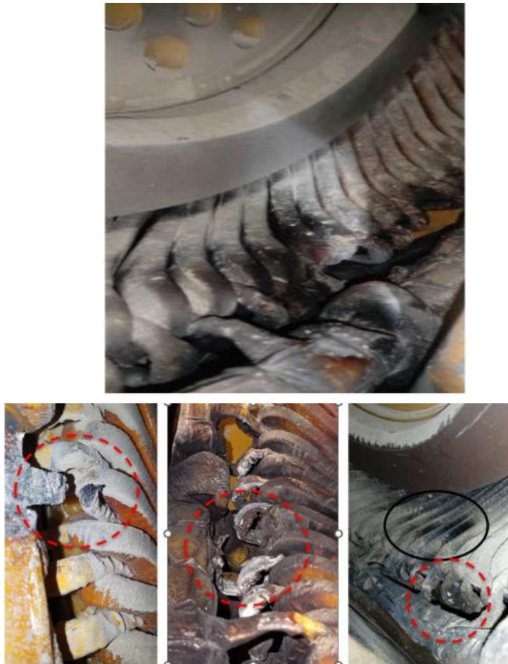
Figura 19. Daño en conexión neutra del estator del motor de tracción.
