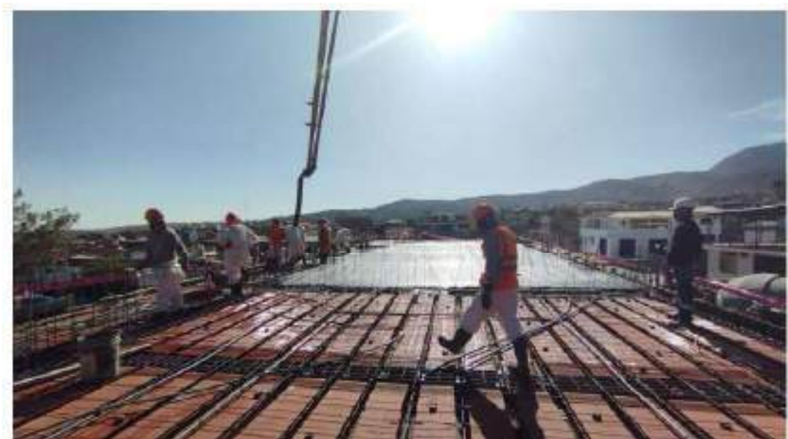
Figura 49. Concreto en comedores (segundo nivel)
