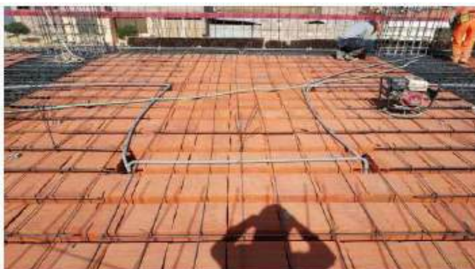
Figura 43. Instalaciones eléctricas en techo de comedores
