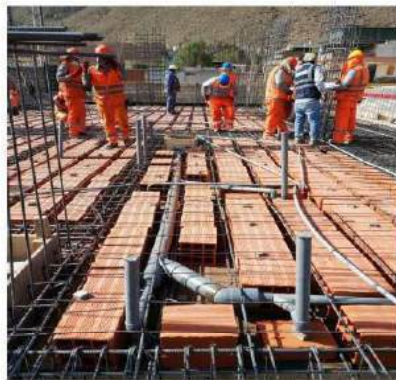
Figura 44. Instalaciones sanitarias en techo de comedores
