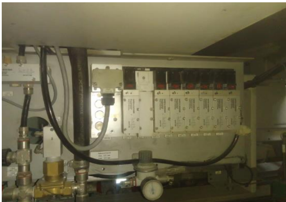
Figura 14. Falla de sistema eléctrico en ensacadora 03.
