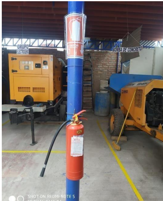
Figura 42 Ubicación de equipo de lucha contra incendios
