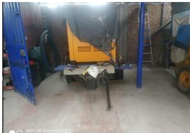
Figura 31 Orden en área de trabajo del grupo electrógeno
