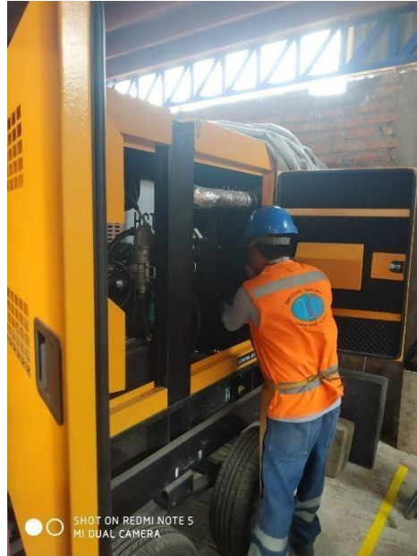
Figura 30 Operador de grupo electrógeno
