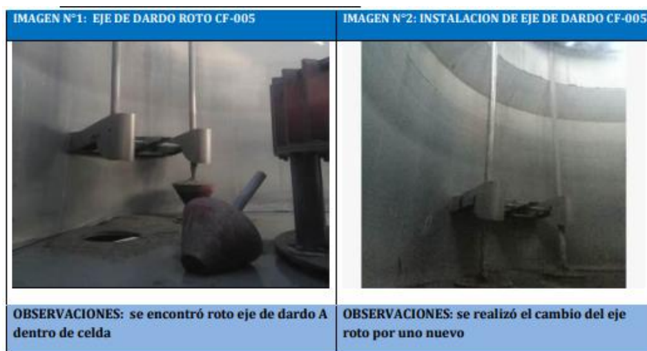
Figura 12. Eje de dardo roto y su instalación de la celda FC-005
