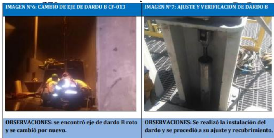
Figura 7. Cambio, ajuste y verificación de dardo B en la celda FC-013
