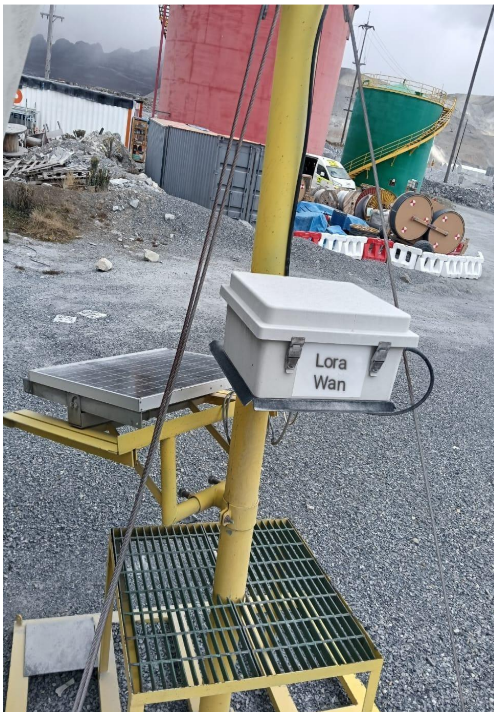
Anexo 7: Prototipo de detección de tormentas instalado
