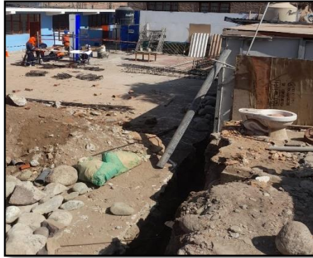
Zanja de cerco perimétrico mal medrado
