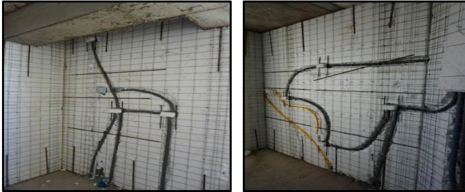
Instalaciones sanitarias y eléctricas
