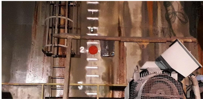
Figura 7. Punto de monitoreo – Estación de bombeo
