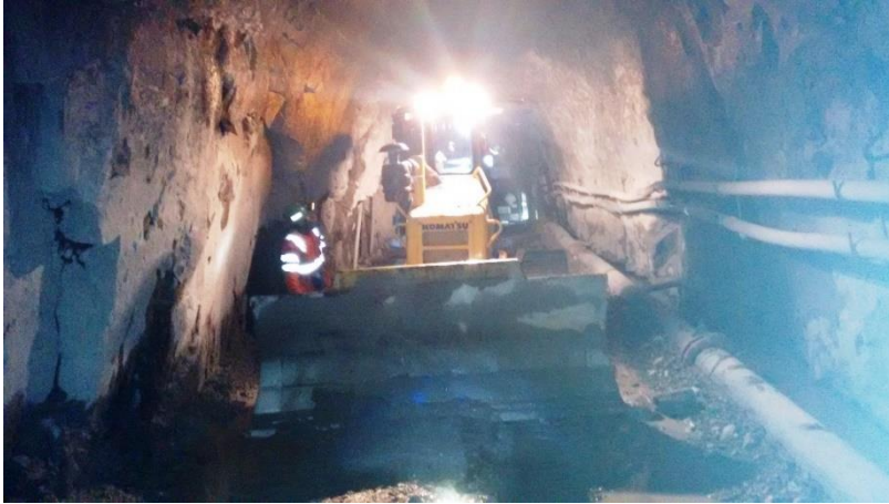
Figura 4. Mantenimiento de las vías en interior mina con empozamientos o charcos de agua.
