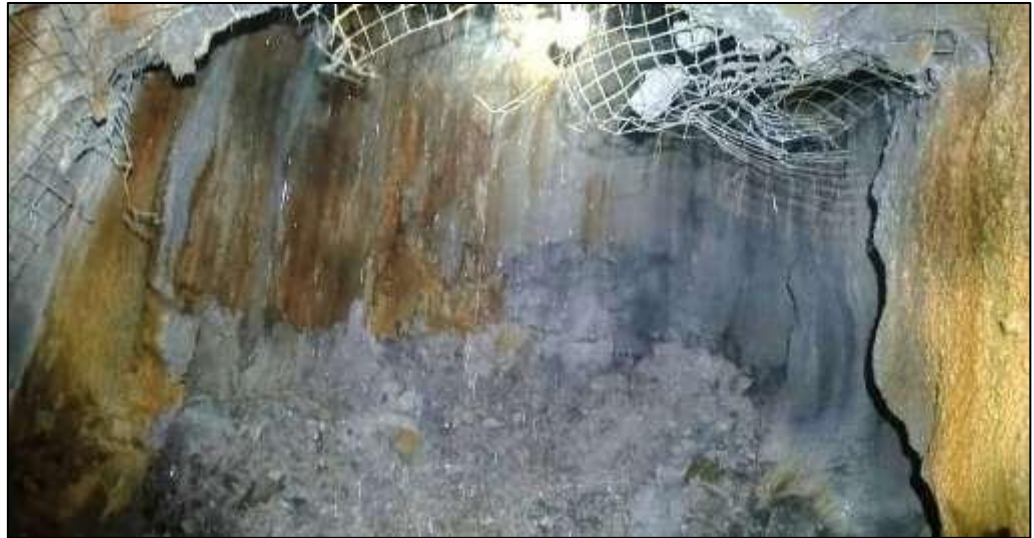
Figura 8. Rampa Liza NV2860 resultado de una voladura deficiente
