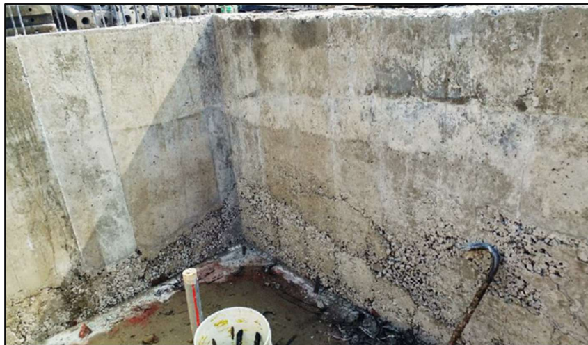
Figura 1. Área considerable de cangrejeras. Tomada de “Control de calidad del concreto y consideraciones en las operaciones para la reducción de costos de no calidad”, por PyS Concreto. 2020.
