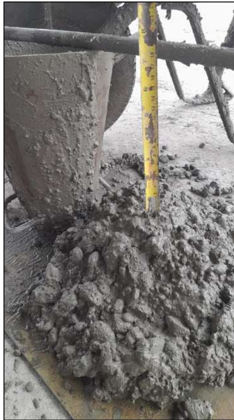
Figura 4. Concreto bombeable para losa aligerada con exceso de grava, Deficiencia en la combinación de agregados en el diseño del concreto bombeable. Tomada en un proyecto de vivienda unifamiliar en Chilca, Huancayo, Junín, 2022.
