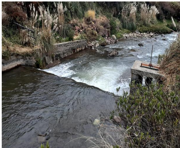
Figura 15. Deterioro el concreto de la bocatoma
