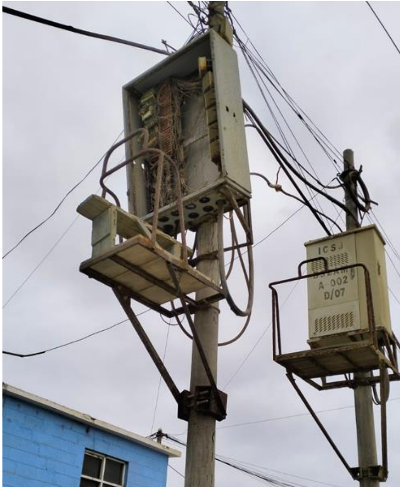
Figura 6. Armario aéreo en mal estado
