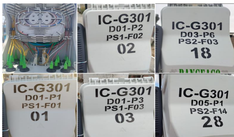
Figura 40. Rotulación caja óptica
