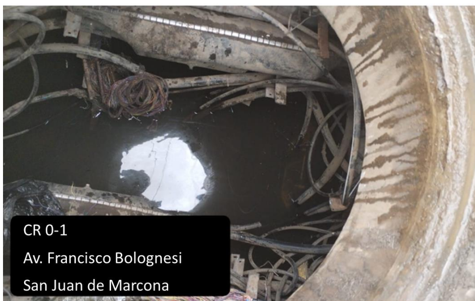
Figura 4. Cámara de paso de cables. Elaboración propia
