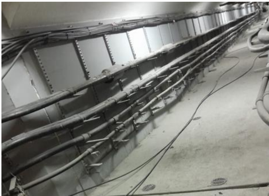
Figura 3. Galería de cables
