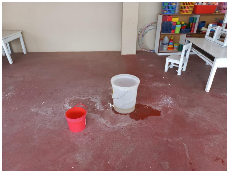
Figura 23. Estado del Piso
