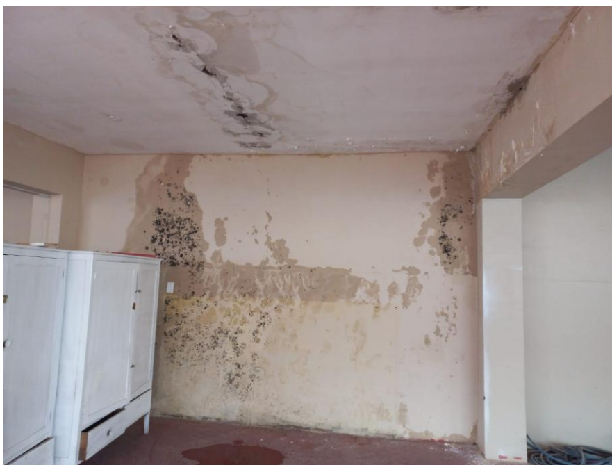
Figura 14. Estado de paredes
