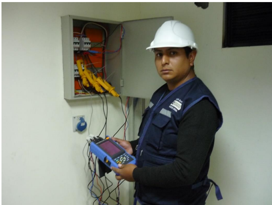
Figura 10: Instalación del equipo en el punto de medición que suministra al pabellón H – Fuente: Propia
