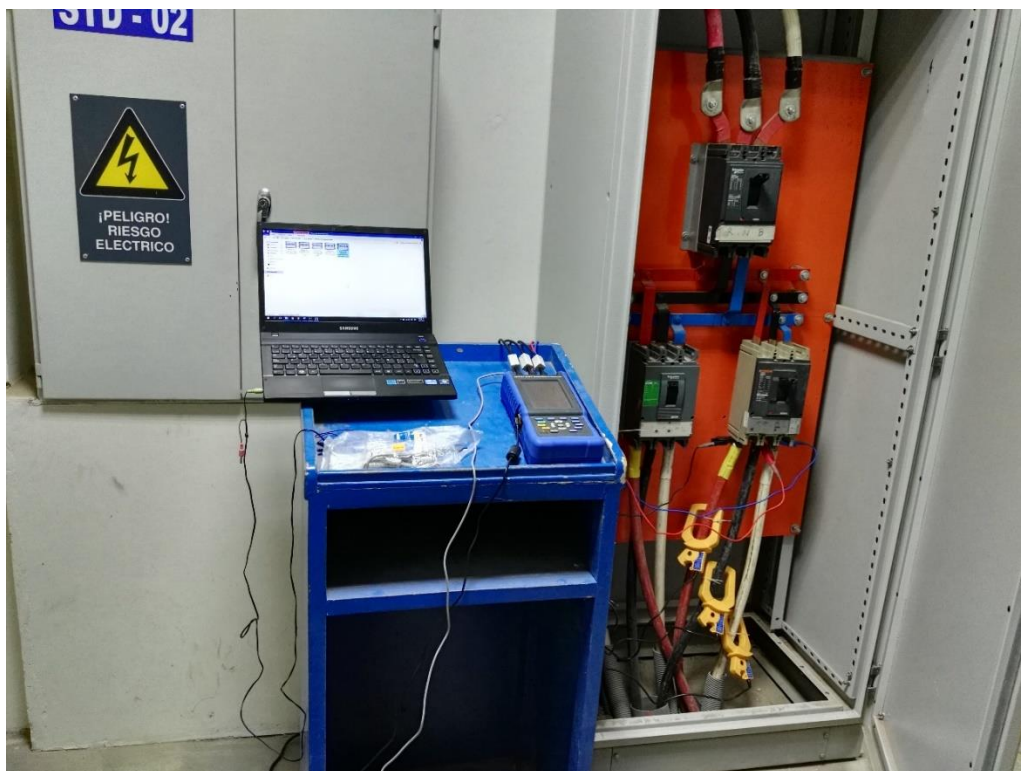
Figura 12: Descarga de los registros del analizador de calidad de red – Fuente: Propia
